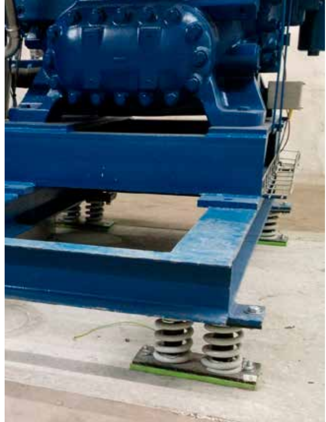
Compresor aislado con VIBRABSORBER+Sylomer®
