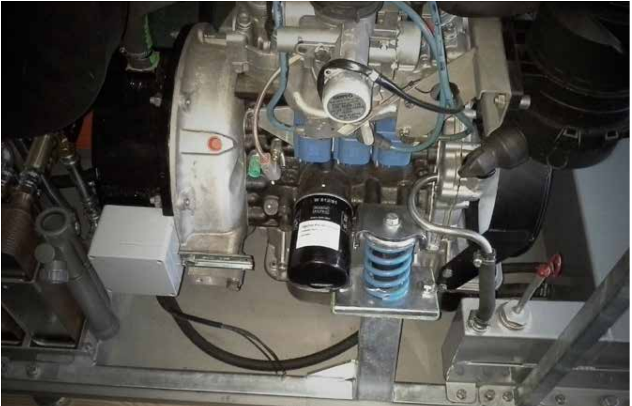
Generador aislado con VIBRABSORBER+Sylomer®
