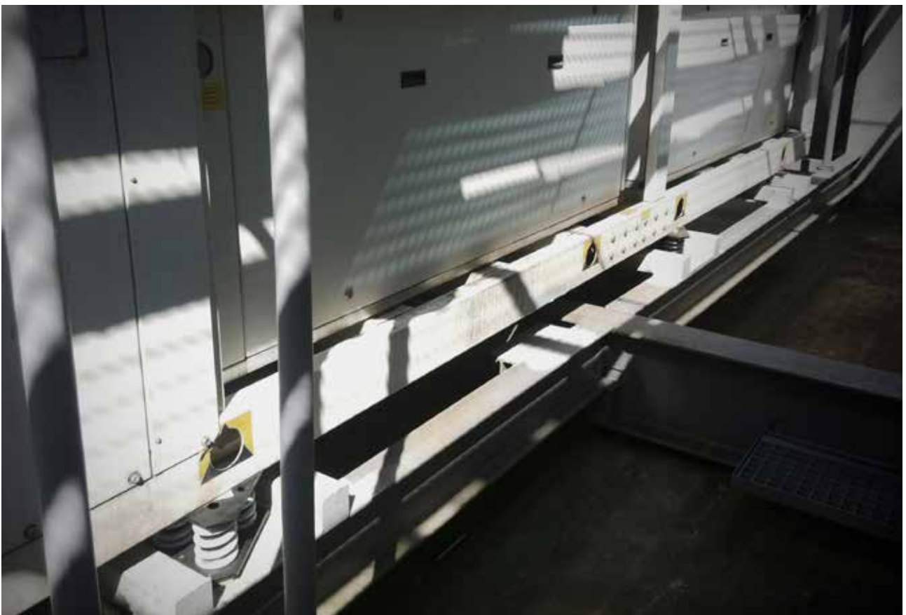
Sistema de ventilación aislado con VIBRABSORBER+Sylomer®
