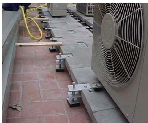
Equipos aire acondicionado (splits, VRV, etc)
