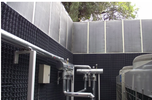
ARCADIS Ingeniería, Sala de Enfriamiento
